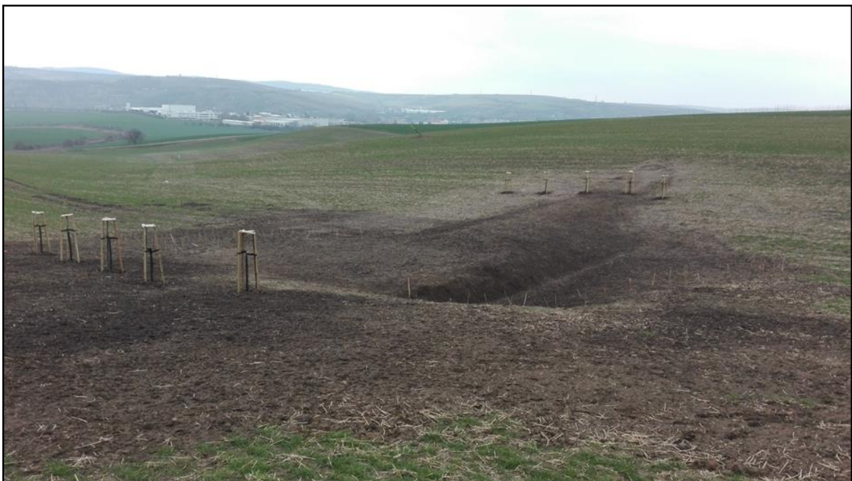
Obrázek 20 Nově vybudovaná přehrážka v zatravněné údolnici v k.ú. Starovice (zdroj: VUV TGM, v.v.i.)
