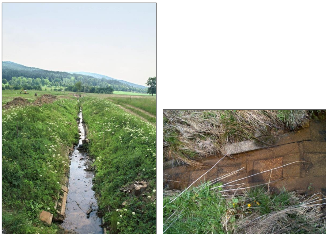
Obrázek 100 Stav koryta před revitalizací, detailní pohled na provedené opevnění při melioraci
