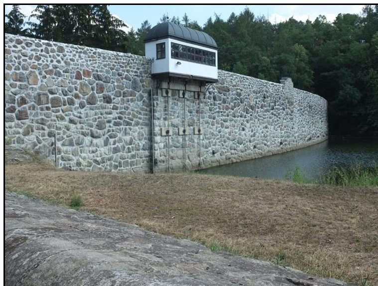
Obrázek 19 Nádrž Jevišovice v srpnu 2015, v popředí hrana bezpečnostního přelivu, zakleslá hladina v důsledku udržování minimálního zabezpečeného průtoku
