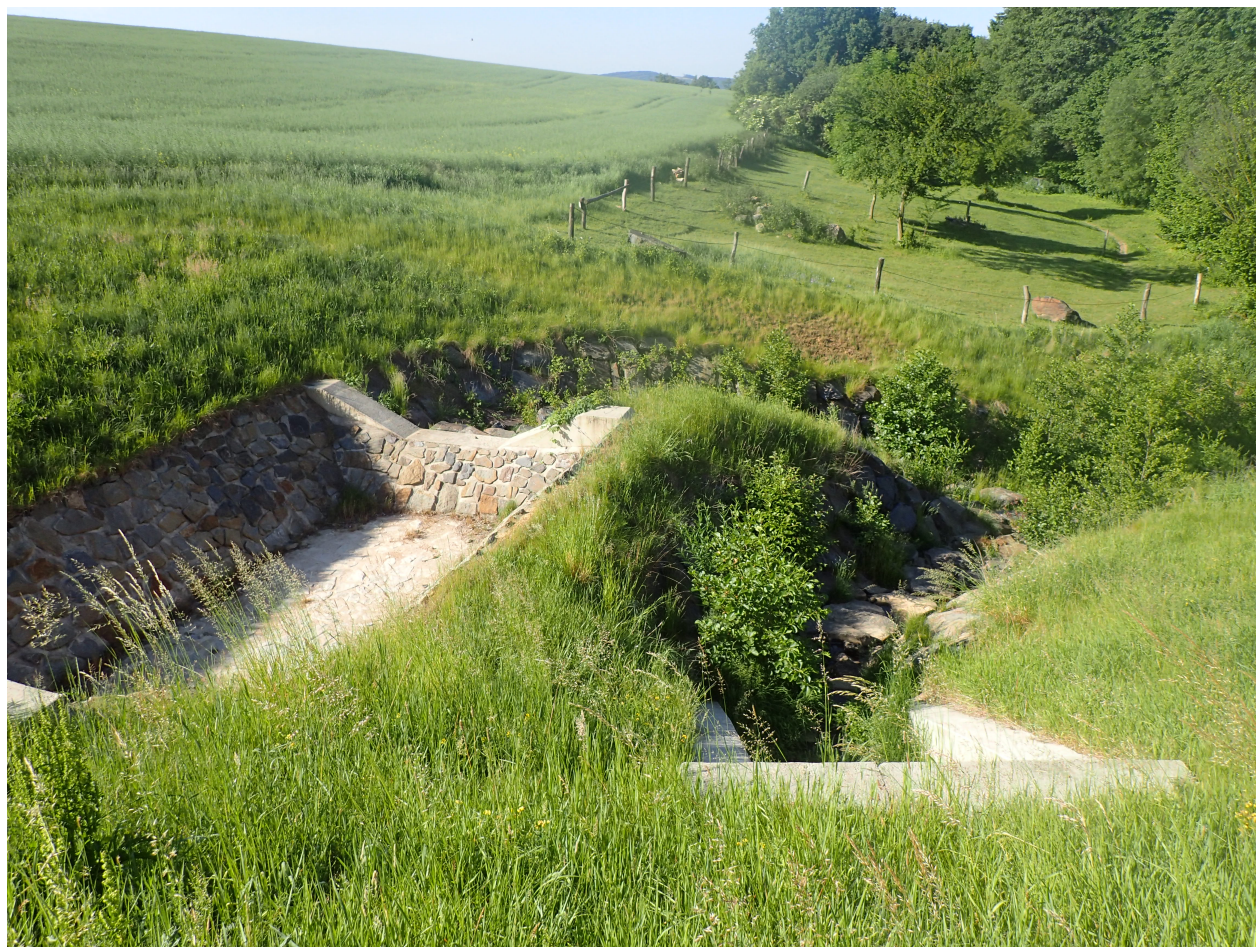
Obrázek 6: Suchá retenční nádrž – výtok z nádrže a přelivu
